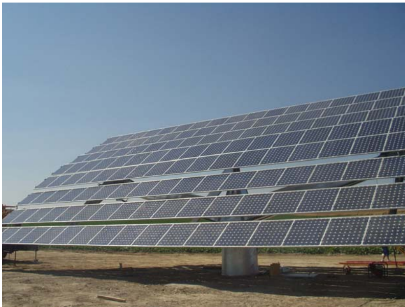
Fig 5. Detalle del seguidor de 25 kWp
