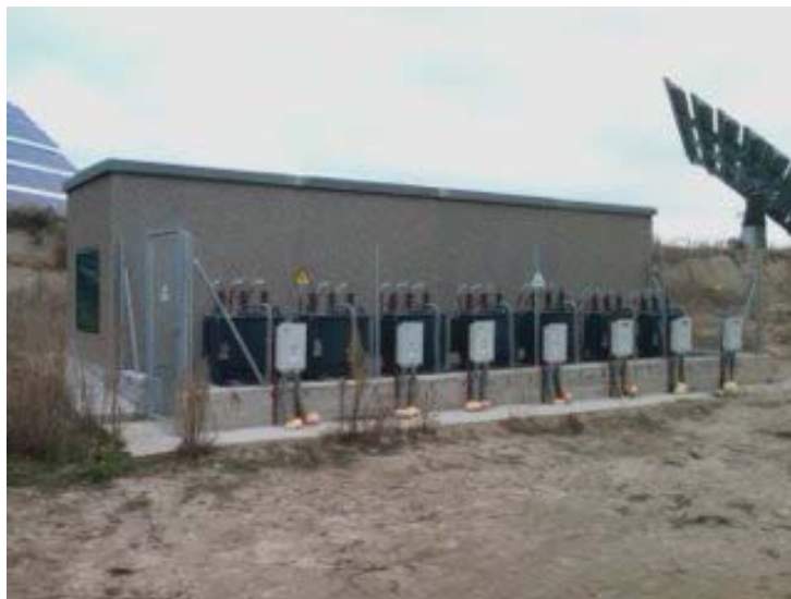
Fig 4. Batería de transformadores de media tensión
