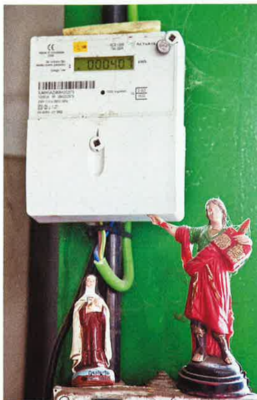
Los santos velan por el rendimiento de la instalación. Los dos módulos han generado 407 kilovatios hora desde agosto de 2009.
